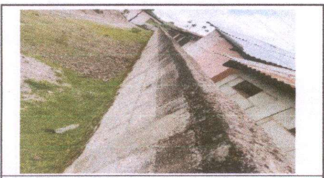
Foto 5: Estado actual del Muro
