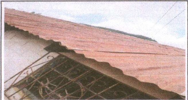
Foto 1: Estado actual del techo.
