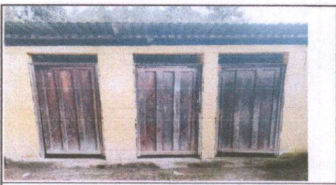
Foto 6: Estado Actual de las puertas de los baños
